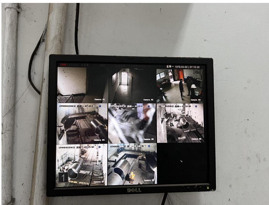
图 4 监控显示装置
